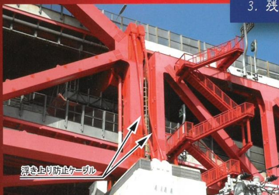
端支承のアップリフトを補う浮き上がり防止ケーブル
